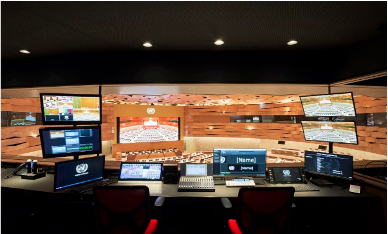
La Sala de Control
